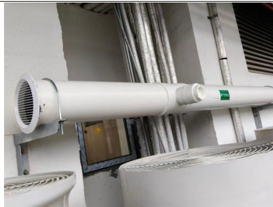
废水站恶臭废气排放口
