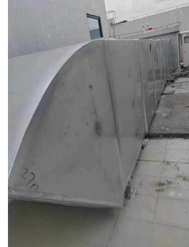
厨房油烟废气排放口
