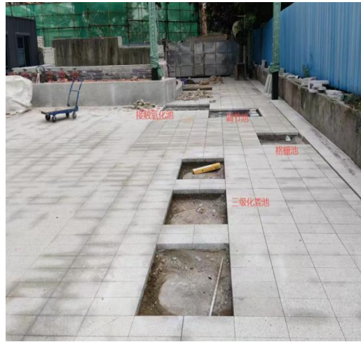
废水治理设施
