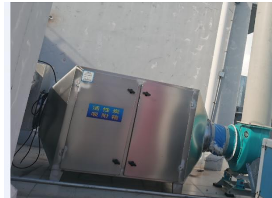
实验室废气治理装置-活性炭吸附
