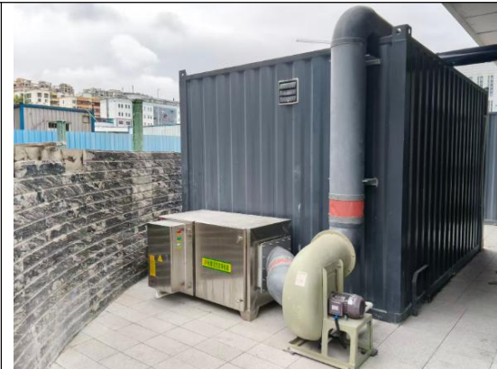
废水站废气 UV+活性炭吸附装置
