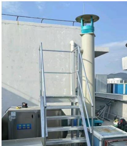
实验室废气排放口
